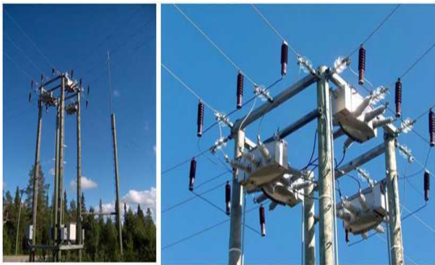
Rys. 2. Podstacja rozdzielcza z izolowanymi rozłącznikami słupowymi SF6 sterowana zdalnie
